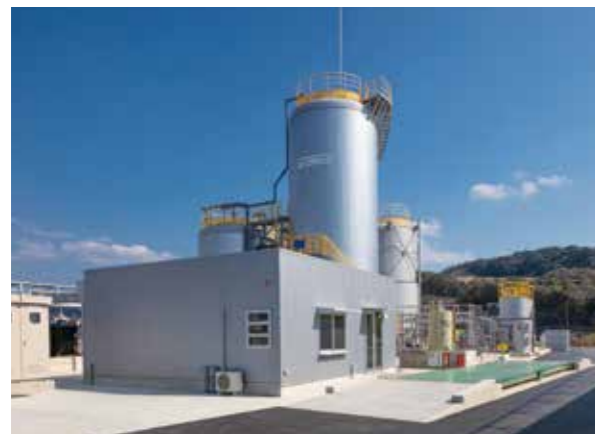
水処理設備(嫌気性排水処理設備)
