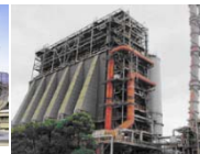
排ガス処理設備
