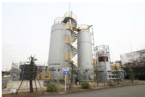
嫌気処理設備（商品名：バイオインパクト）：他社事例
