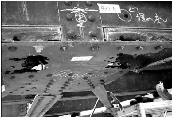
図2 ガセットプレートの腐食状況 Corrosion of gusset plate
