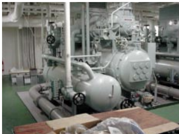
図4 冷凍圧縮機 Refrigerating compressor
