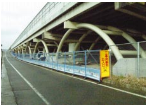
図5 アーチリブ形補強材による耐震補強 Aseismic reinforcement using steel arch rib members
