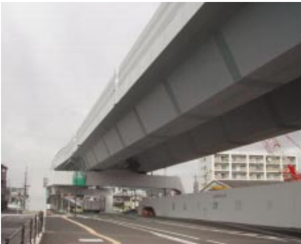
図2 福岡北九州高速道路公社501工区（開断面箱桁） Fukuoka Kitakyushu Urban Highway 501 work section
