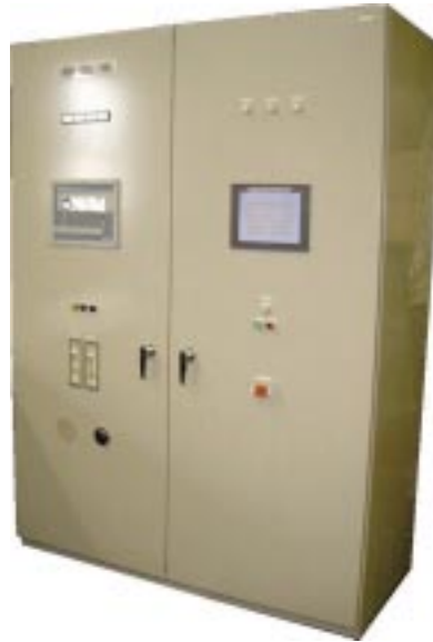
図1 蒸気タービン起動盤 Turbine control panel
