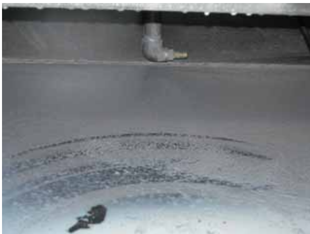
図4 タンク底のスラッジ沈澱状況 Sludge condition of tank bottom
