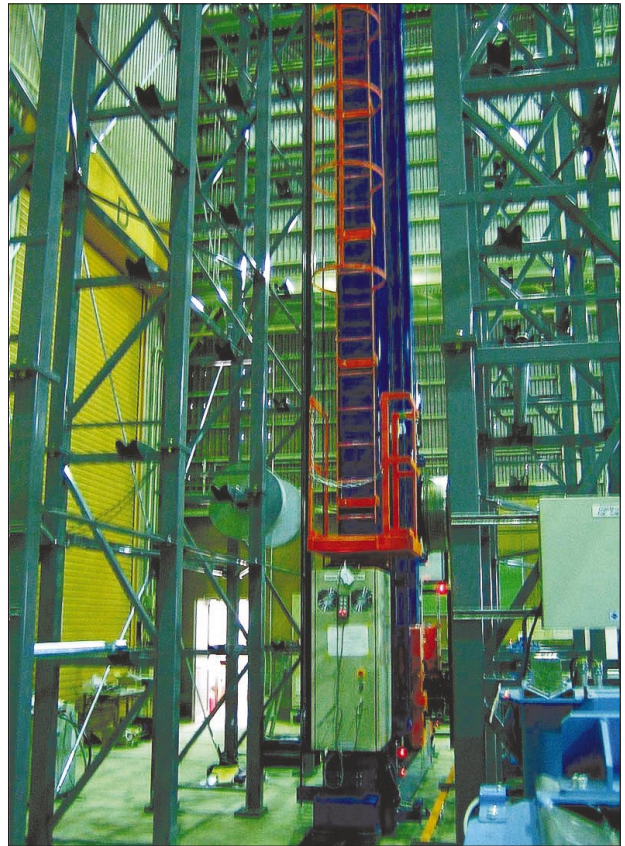
ロジスティクス&パーキングシステム事業部
