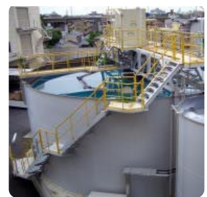
高速凝集沈殿処理設備
