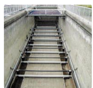
下水・水処理設備
