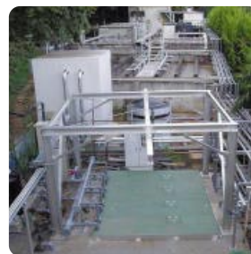
浸漬膜処理設備
