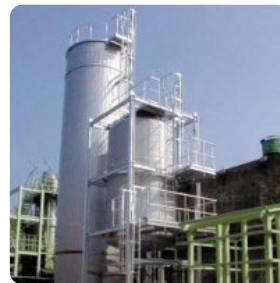
嫌気性処理設備
