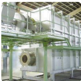
下水・汚泥処理設備
