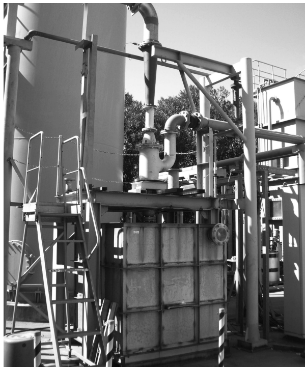
実証試験設備 Proof facilities
