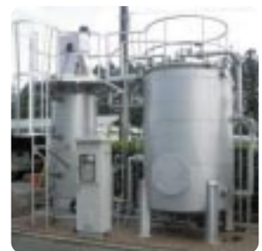
排水処理設備 周辺システム
