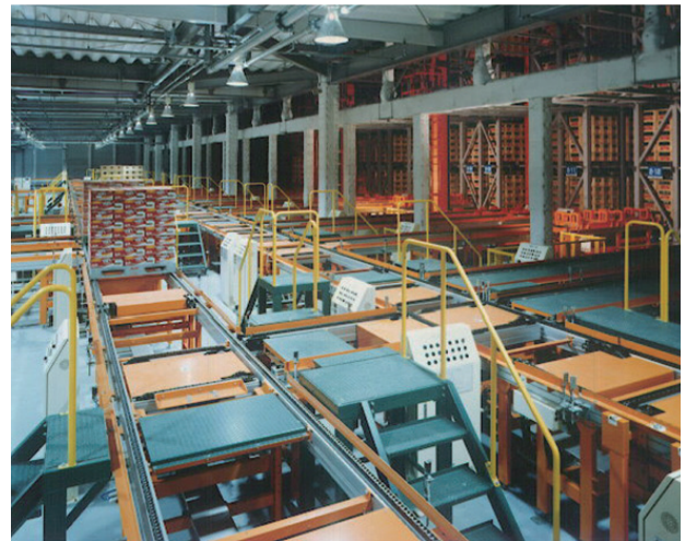
図3 高速コンベヤライン High speed conveyor line
