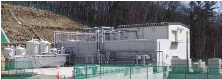
〈住友重機械エンバイロメント株式会社〉
