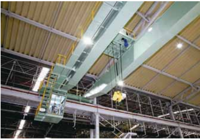
図2 天井クレーン(OHC) Overhead crane
